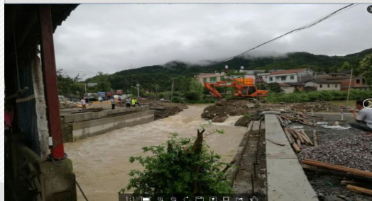
施工便道被冲毁
